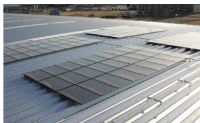
屋根に取り付けられた太陽光発電システム
